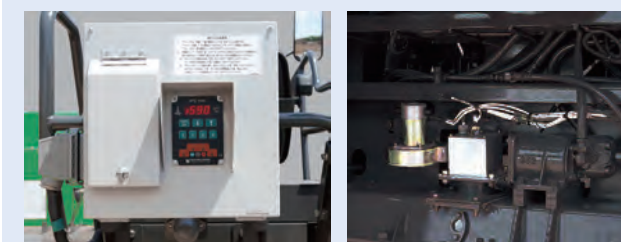
コントロールボックス
