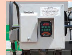
コントロールボックス
